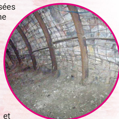
L'affaissement des cintres (enfoncement de la structure dans le sol) est une conséquence des outrages du temps et de la nature sur ces galeries de mine reconstituées.
